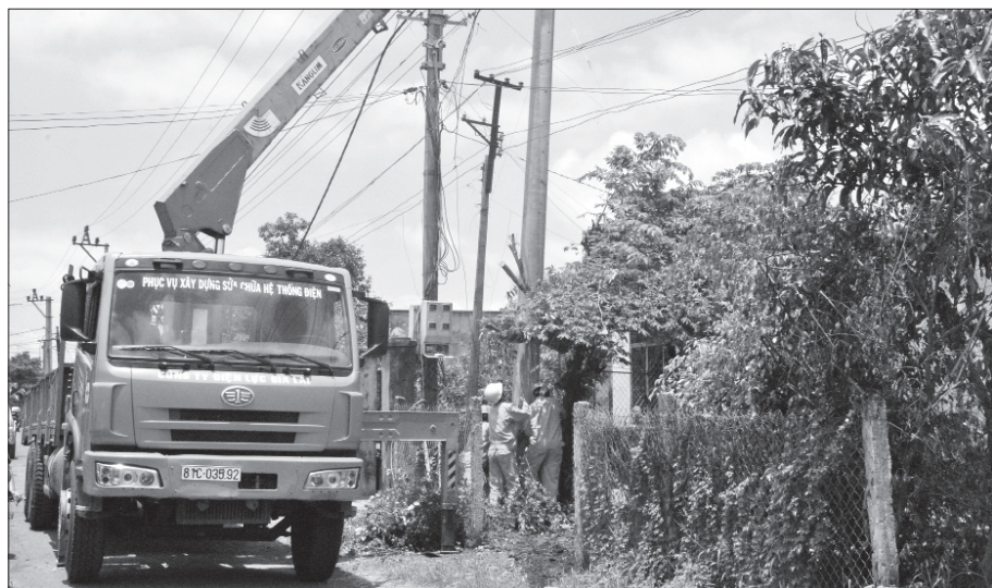
Đóng điện trạm biến áp 110kV Mang Yang (Đức Cơ, Gia Lai)
