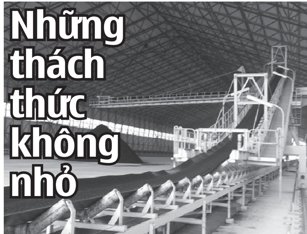
Tiếp nhận than tại Nhà máy Nhiệt điện Vũng Áng 1
